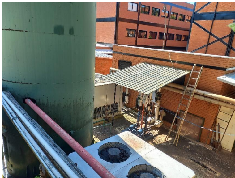
Figura 3 - Localização atual do reservatório em relação a cabine de energia
